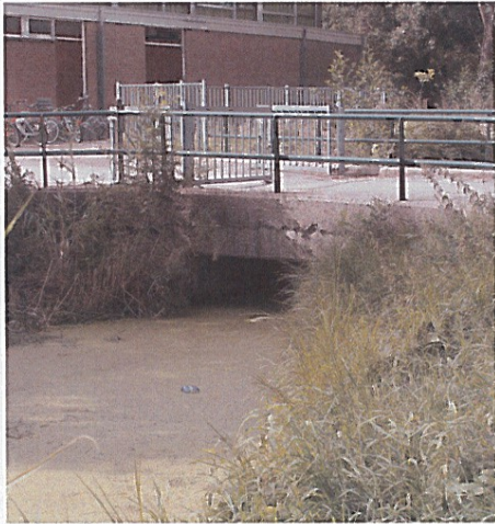
Knelpunt 11 - toegangsweg naar school - voldoet niet
