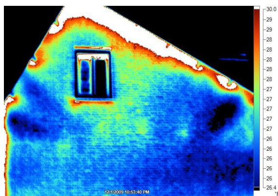
figuur 5.2 Infrarood foto van een zijgevel met warmtelekken
